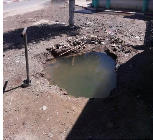
Photo 1.2. Fuites sur réseau de distribution
