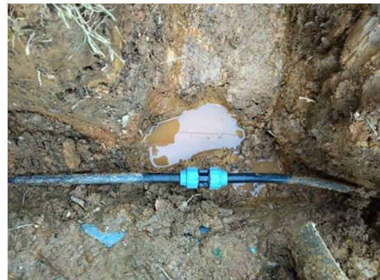
Photo 3.6. Fuite sur un branchement
