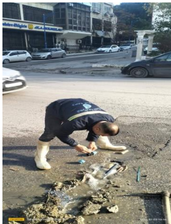
Photo 1.3. Fuites sur un branchement
