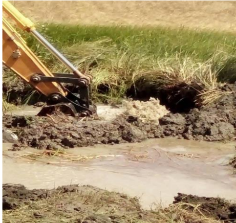
Photo 1.1. Fuites sur réseau d'adduction
