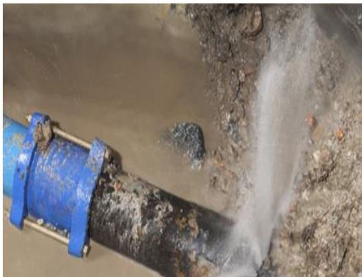
Photo 3.5. Fuite sur une conduite en Acier
