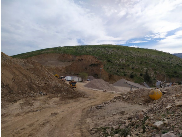
Figure 6. Photo montrant la perturbation de la topographie par la création d'une piste pour un chantier.
