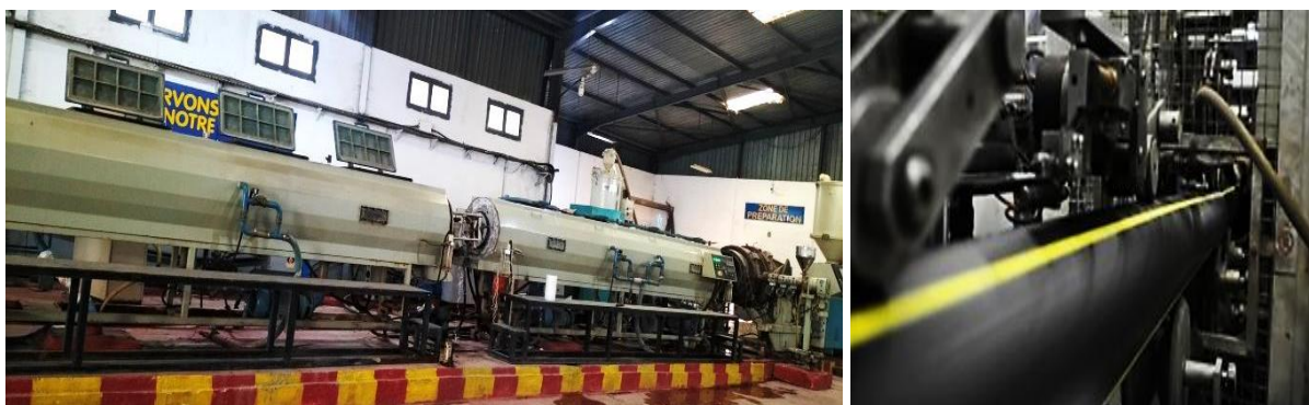
Figure I. 1. Ligne d'extrusion de tubes HDPE (SARL TUBOGAZ Annaba).
