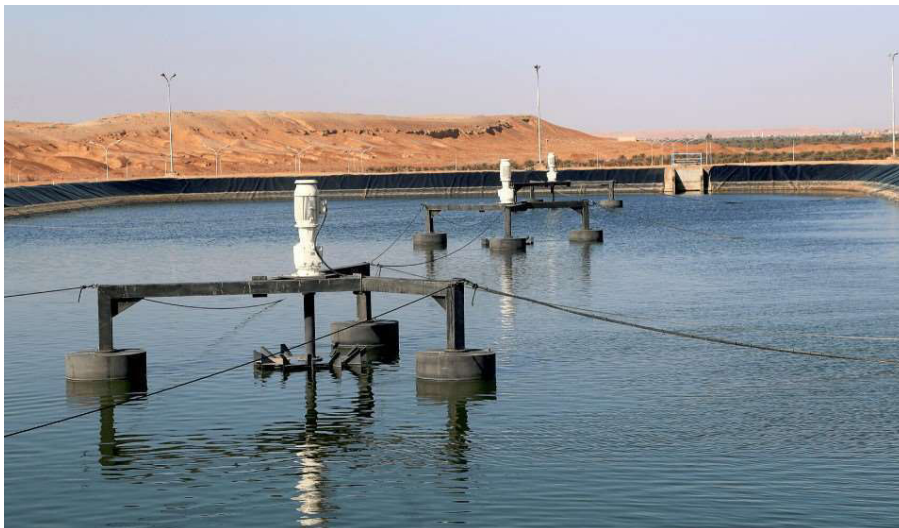
Fig. 01 : Station d'épuration des eaux usées par lagunage aéré El Guerrara, Ghardaïa, Algérie (Amenhyd, 2012).
