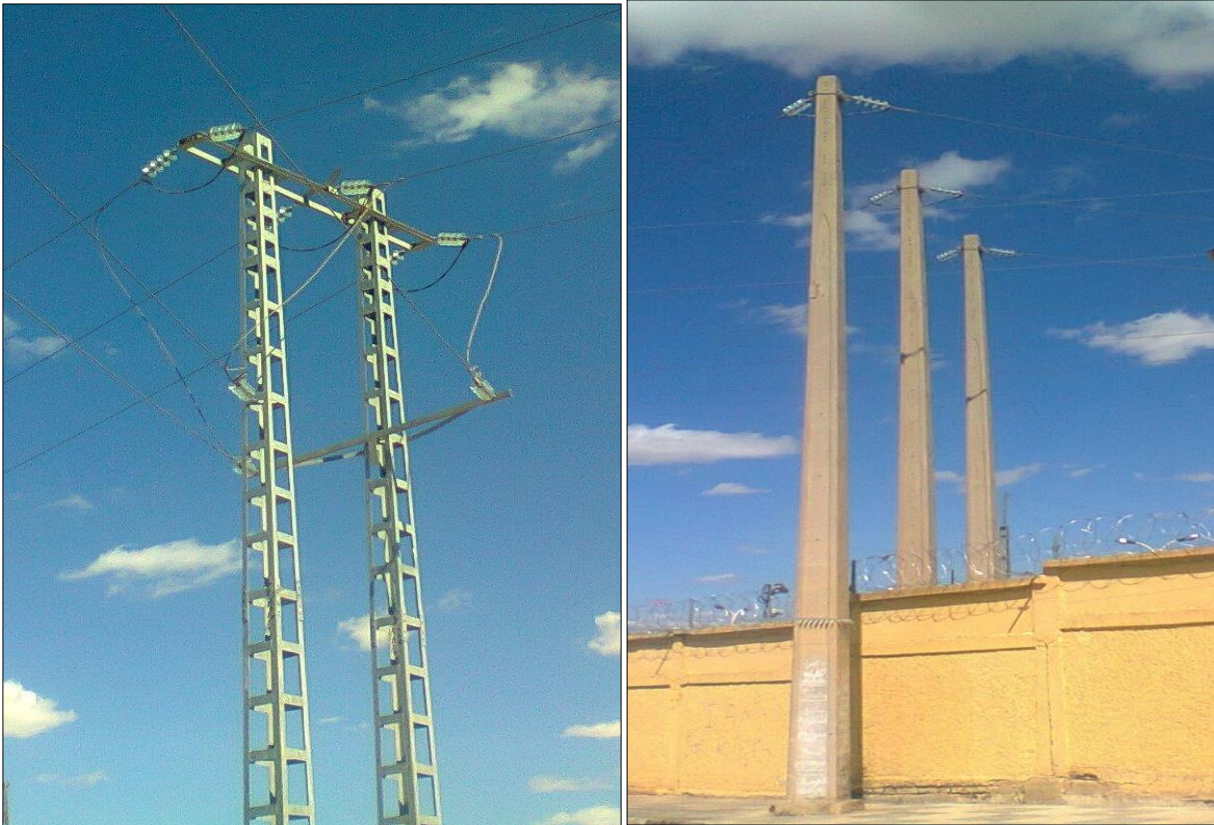
Figure 5.6. Les types des supports de la ligne 30kV OUED KEBRIT / EL AOUNET [56] [58].
