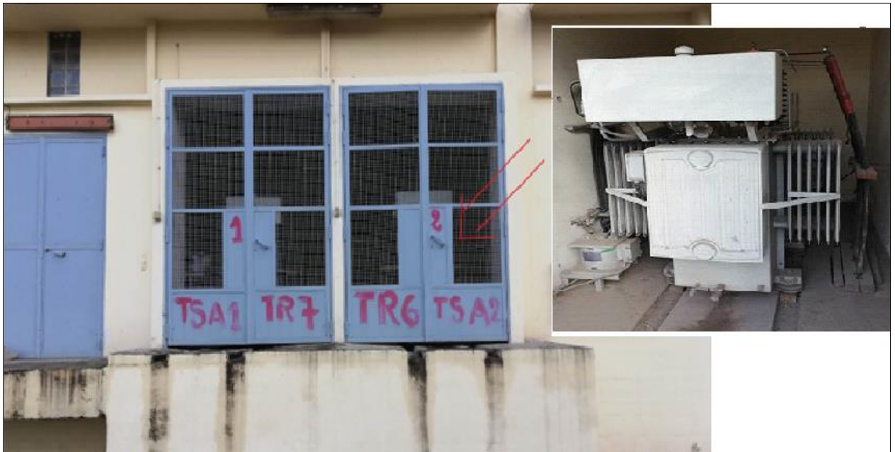
Figure 3.11. Local des auxiliaires du poste 220/90/60/30kV EL HADJAR [53]
