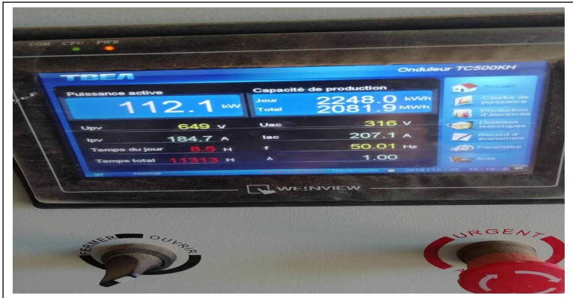
Figure 4.30. Afficheur d'un onduleur au niveau de la centrale photovoltaïque OUED KEBRIT
