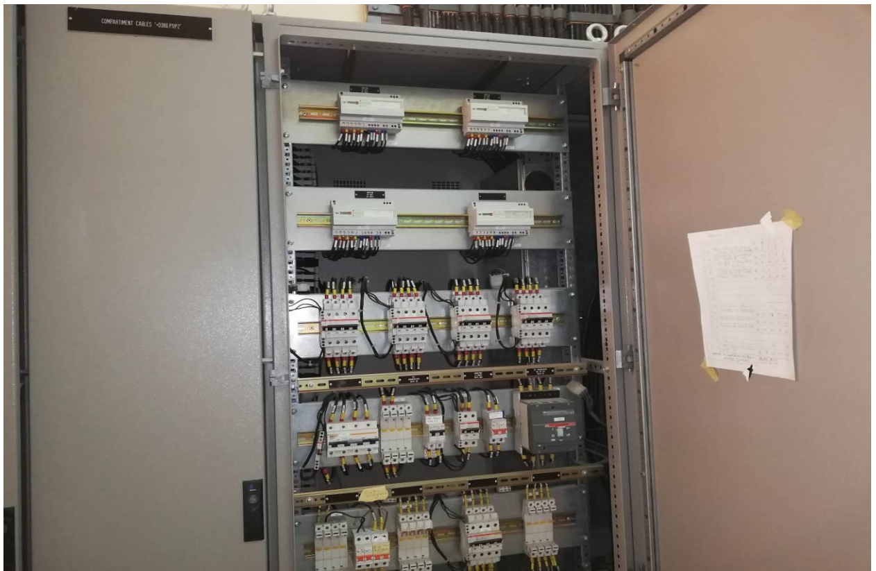
Figure 3.9. Armoire des auxiliaires du poste 220/90/60/30kV EL HADJAR [53]
