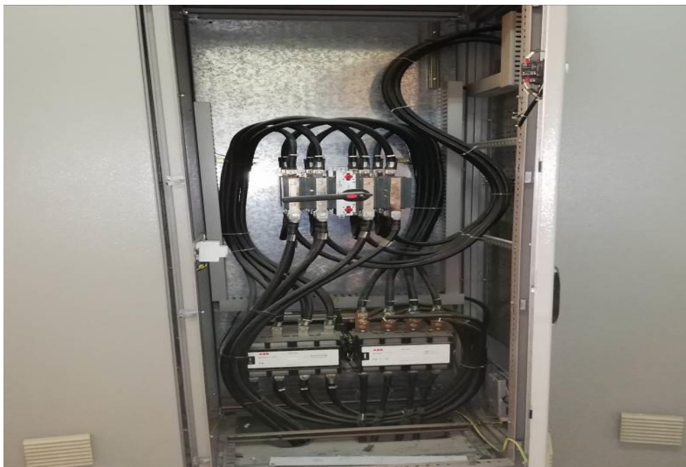
Figure 3.10. Raccordement de l'armoire des auxiliaires [53]
