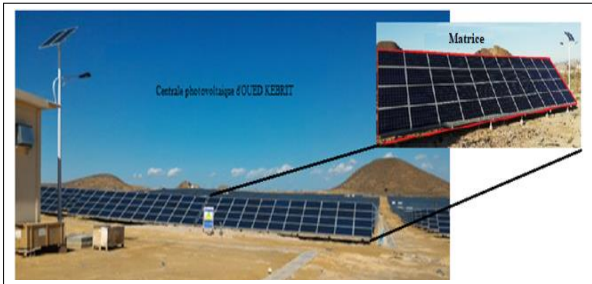
Figure 4.3. Les panneaux photovoltaïques de la centrale OUED KEBRIT.
