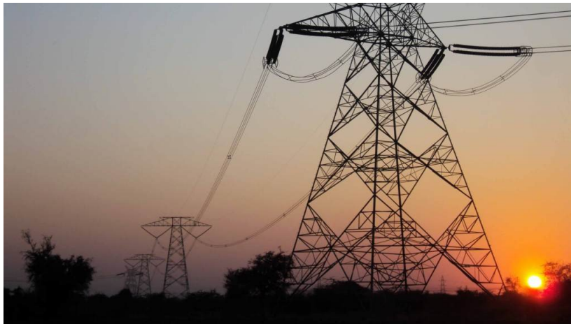
FIGURE 1.2 – Ligne aérienne HVDC de \pm 500 kV / 2000 MW.
