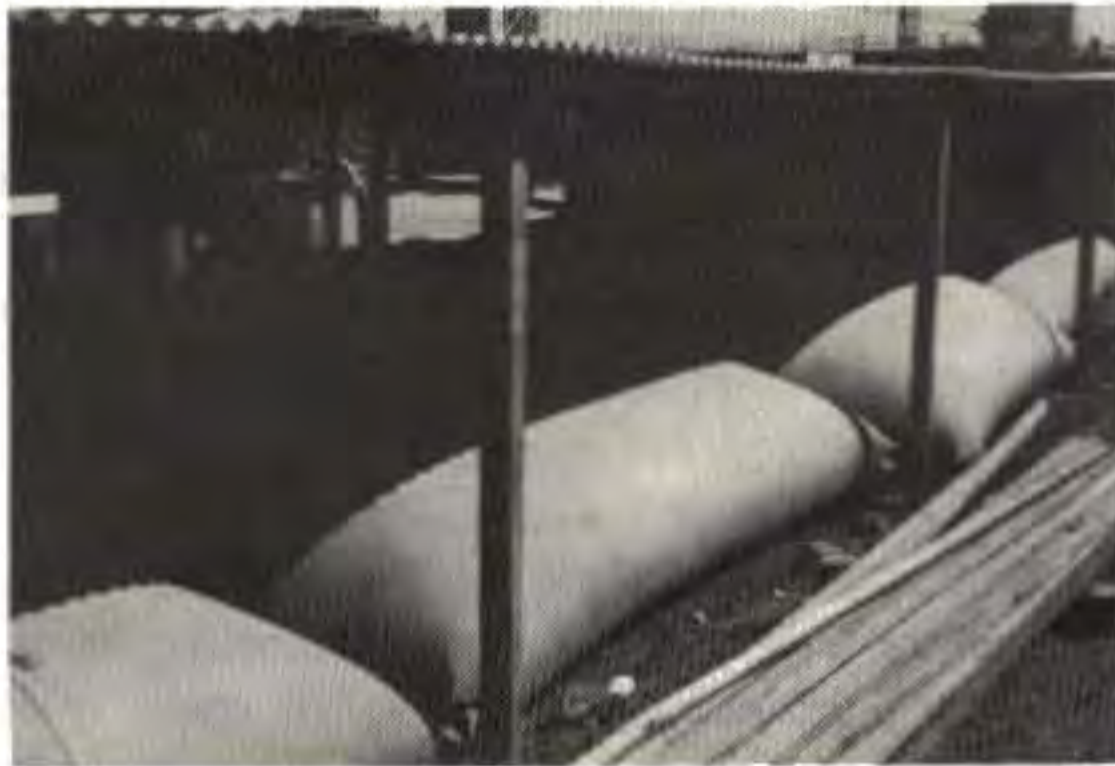
FIG. 104. — Stockage de l'eau sur chantier dans des bâches en toile plastifiée sous abri solaire (doc. S.A.E.).
