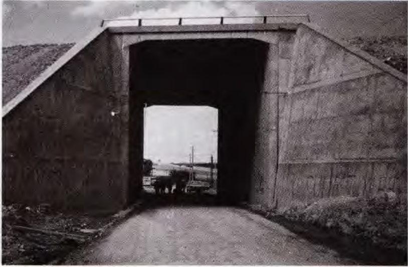
Fig. 3.9 - Mauvaises proportions : le tirant d'air est trop grand pour l'ouverture (photo SETRA).
