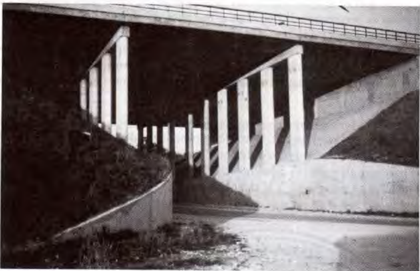
Fig. 3.40 - Enchevêtrement de poteaux (photo SETRA)
