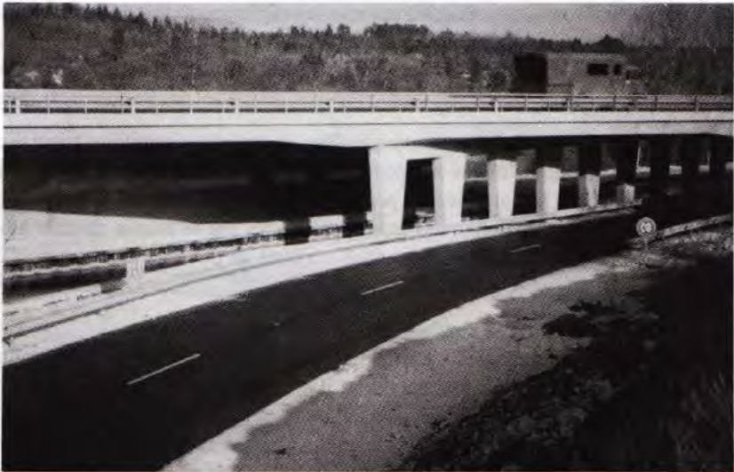
Fig. 3.41 - Effet désagréable : pile en retrait au droit du gousset (photo SETRA).
