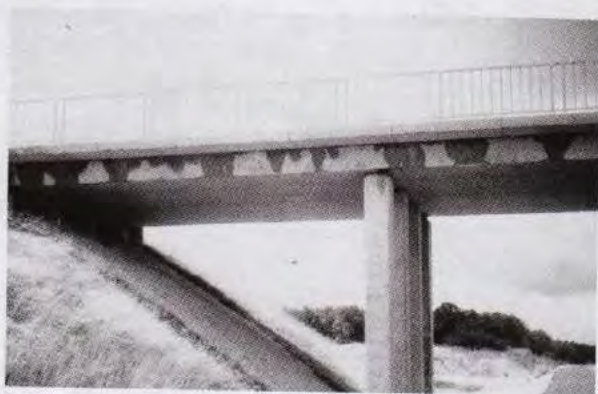
Fig. 3.30 - Conséquences d'un défaut d'étanchéité (photo SETRA).
