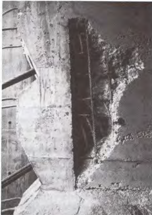
Fig. 5.20 - Défaut de bétonnage derrière un bloc d'about préfabriqué (photo JAC).
