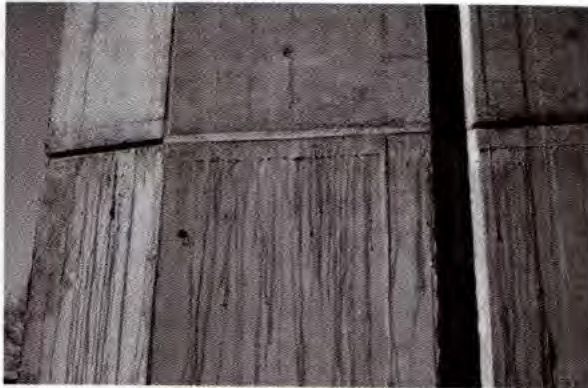
Fig. 3.35 - Qualité de parement défectueuse (photo SETRA).
